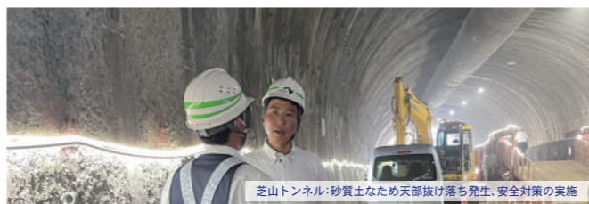
芝山トンネル:砂質土のため天部抜け発生、安全対策の実施
